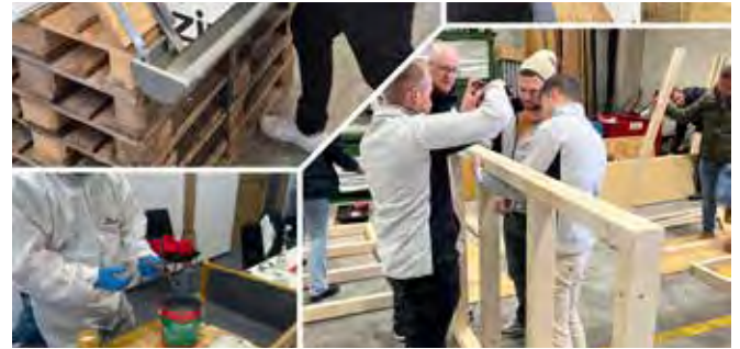
Praxisnah lernen: In Workshops zu Fassade, Holz, Metalle, Photovoltaik und Flachdach konnten die Teilnehmenden Systeme, Materialien und Anwendungen direkt in der Praxis erleben.
